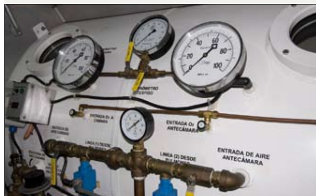
Figura 10. Cámara hiperbárica multiplaza instalada en la base "Jubany" de la Antártida.
